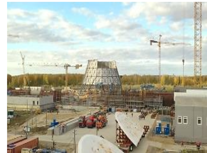
Модуль переработки опытно-демонстрационного энергокомплекса с реакторной установкой БРЕСТ-ОД-300
